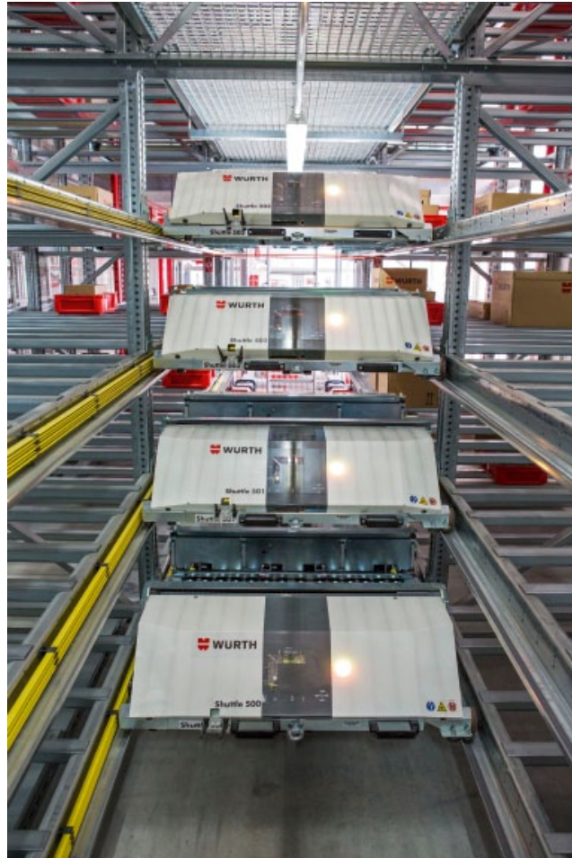
Blick in den Paketpuffer bei Würth: Ebenenbediengeräte im Shuttle-Lager.
